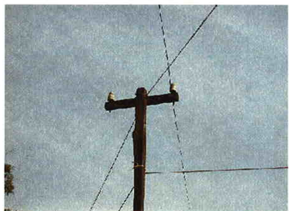
碍子を用いた配電線・電柱
