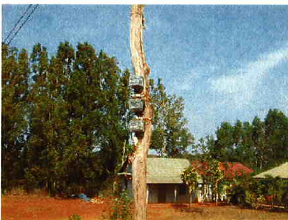
電柱に取り付けられた電気メーター センモノロム市内
