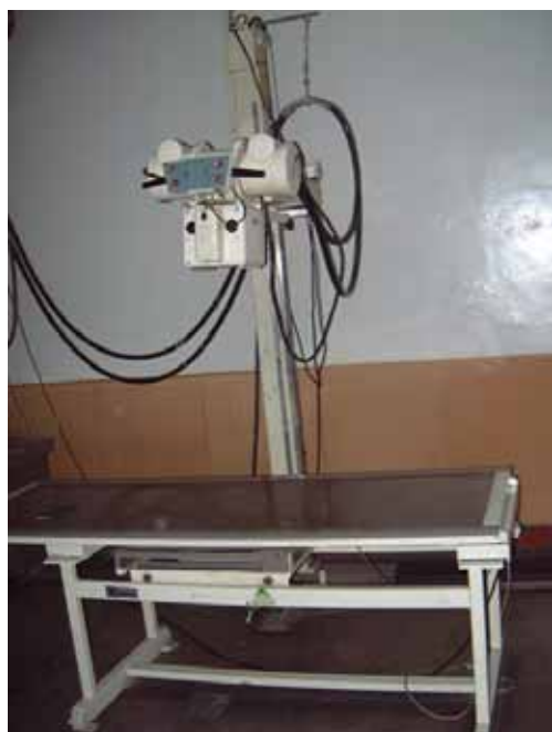
放射線科：一般用X線撮影装置 ブッキー装置故障により一部機能使用不能
