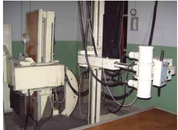
放射線科：X線撮影装置 老朽化により一部機能が使用不能
