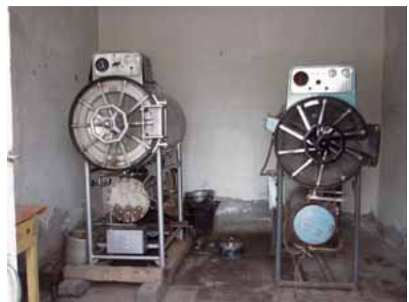
材料滅菌室：高圧蒸気滅菌器 老朽化により度々故障
