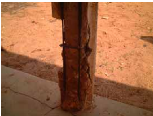
Le béton des piliers s'effrite et les armatures sont dénudées.
