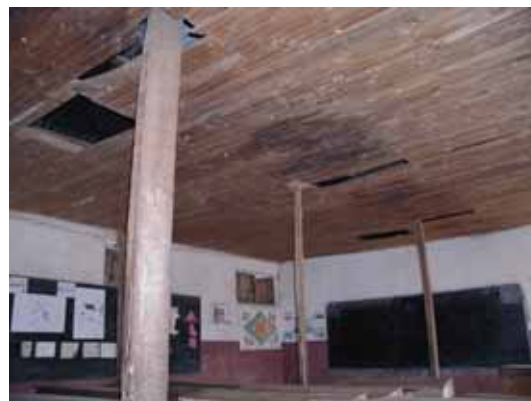
Exemple d'un cas où des poteaux ont été installés dans le milieu de la salle de classe pour soutenir les fermes.
