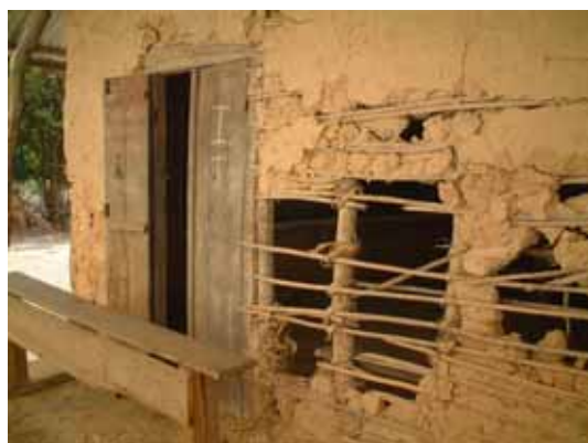
Bâtiment scolaire dont les murs extérieurs sont en torchis. Bâtiment scolaire dont l'utilisation de façon permanente n'est pas viable et pour lequel il a été estimé que la seule utilisation possible était en tant que salle de classe provisoire.
