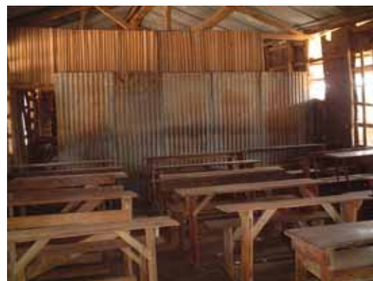
Bâtiment scolaire dont les murs extérieurs sont en torchis et dont les séparations murales utilisent de la tôle galvanisée. Bâtiments scolaire qui représente des problèmes au niveau de l'insonorisation et qui ne convient pas à l'environnement d'apprentissage.
