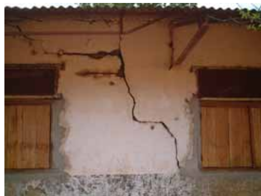
Fissures dans les murs.
