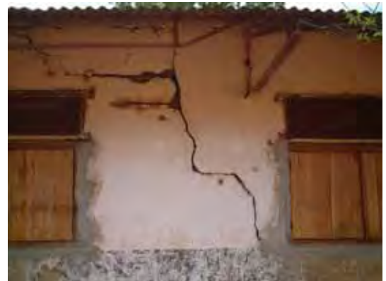
壁面の大きなクラック。
