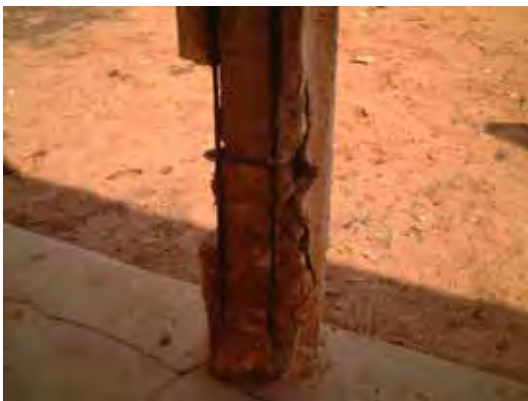
柱のコンクリートが剥離し、鉄筋が剥き出しとなっている。
