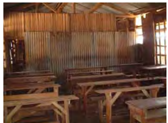
外壁は土壁、間仕切壁は垂鉛鉄板を使用している。遮音上の問題があり、学習環境として相応しくない。
