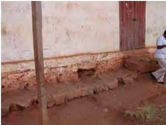
基礎が剥き出しとなっている。
