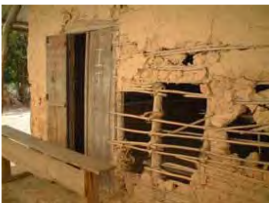
土壁の外壁で建設された校舎。耐久性に問題があるため、仮設教室と判断せざるを得ない。
