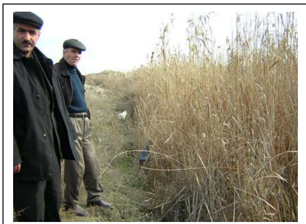
③メインシルヴァン支線排水路の堆積土砂状況雑草（アシ）の繁茂
