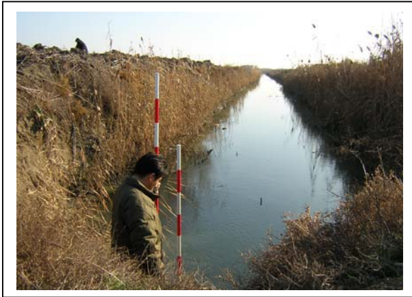
⑦メインシルヴァン排水路の堆積土砂実測状況 (サートゥリィ地区)
