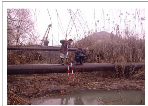
②メインシルヴァン排水路の堆積土砂実測状況
