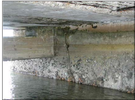
写真 ミュンズ-No.2 南側縦壁クラック発生状況
