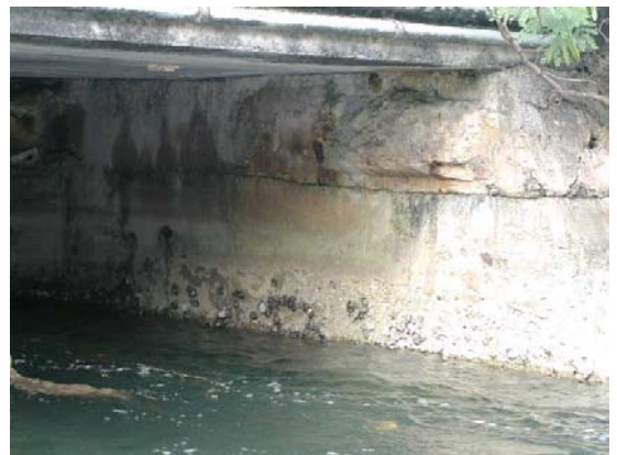
写真-29 マラカル-No.2 水平クラック
