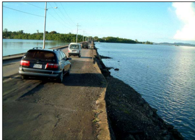
写真:ミュンズコースウェイ。補修部の陥没
