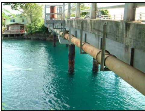
2 添架されている上水管。
