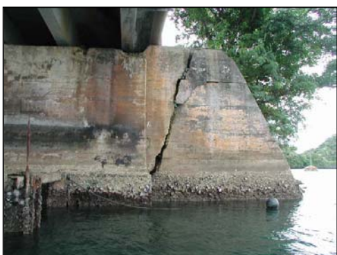
4 マラカル側(A1)橋台前面擁壁現況。亀裂が生じているのは、旧橋台(現擁壁)のオープンウイングに当たる箇所である。
