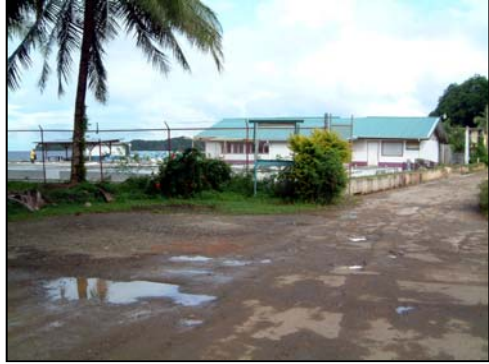
1 マラカル島内道路起点部に近いマラカル水産試験場。路面状態は悪く、ポットホールが数多く生じている。
