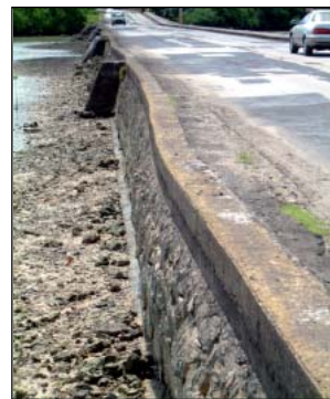
写真:ミュンズコースウェイの護岸工現況。扶壁、もたれ式擁壁による補強、既設護岸工の孕み出しが各所に見られ、3コースウェイの中で最も損傷度が激しい。
