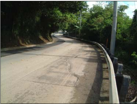
2 地滑り発生箇所。右側は、海に通じており、高低差約 5m。
