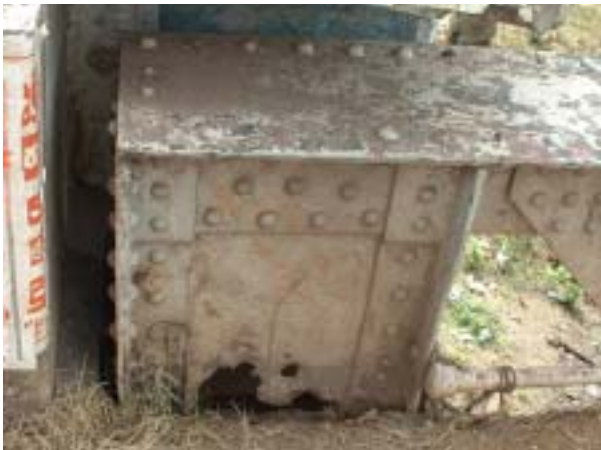
支点鉛直材の腐食穴（約 20cm）。支点反力を伝える主要部材で危険な状況だがリベット構造のため補修は困難
