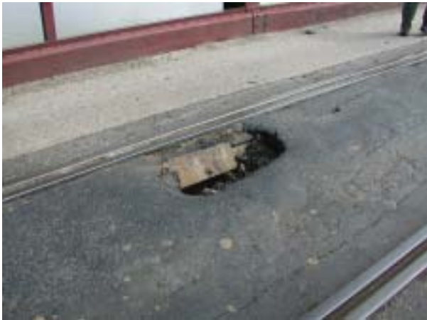
路面の陥没(大きさ約 30cm)。RDA は鉄道に委託して補修する予定
