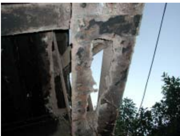
下弦材の腐食による著しい断面減少。完全に穴が開いている。主要部材で危険な状況だがリベット構造のため補修は困難
