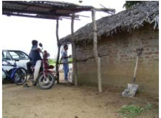
右岸取り付け道路沿いの家屋壁に残る洪水痕跡
