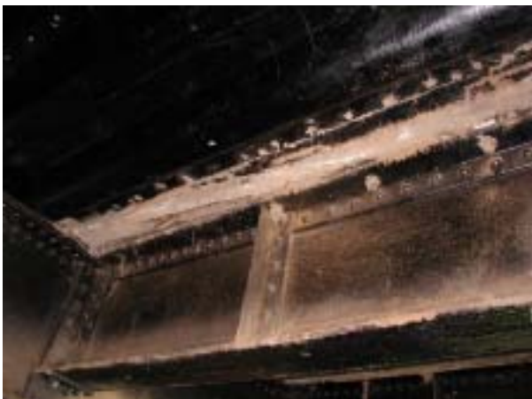
路面下の横桁の汚れと腐食。路面からの漏水が原因と考えられるが橋梁構造の安全には影響ない。
