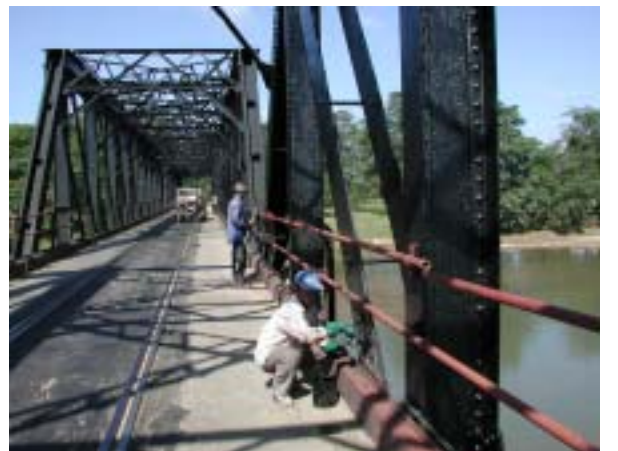
塗装保守の状況。錆止め塗料(赤茶色)の上にタールエポキシ塗料(黒色)を塗っている。
