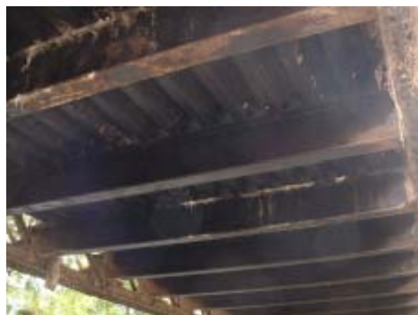
床版（波板鋼板）と横桁の腐食。路面からの漏水が原因。床版の取り替えと横桁の補修は可能だが交通規制を伴う。
