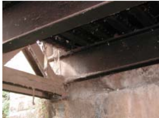
支承上の泥の堆積。左写真に示す支点鉛直材の腐食穴から漏れ落ちたらしい。また、路面からの漏水による床版（波板鋼板）と端横桁上フランジの腐食も見える。
