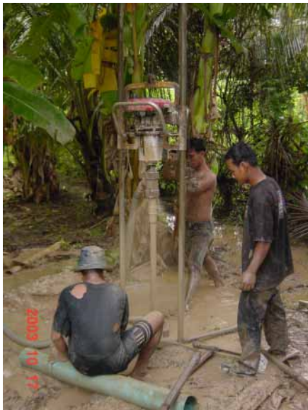
民間の小規模井戸掘り業者による井戸掘削 50m まで掘進中、金額は一律 US120
