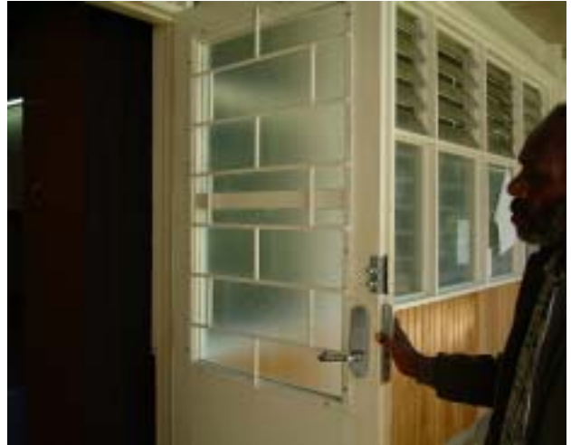
セキュリティ窓枠・二重鍵(教育工学教室)
