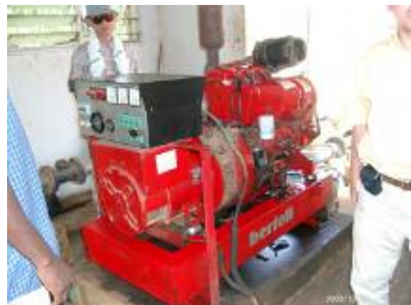
発電機（日本施工施設）
