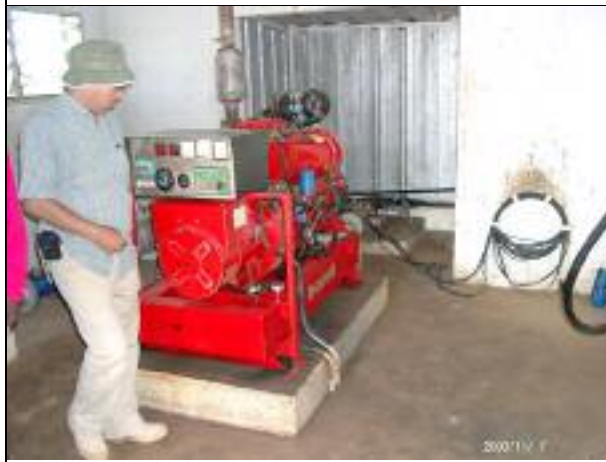
日本施工の給水施設、発電機室内部
