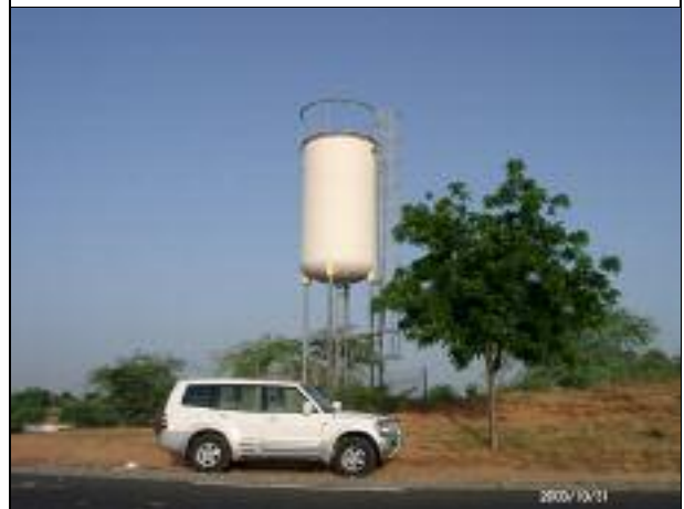
イタリアの建設した給水施設（給水塔）
