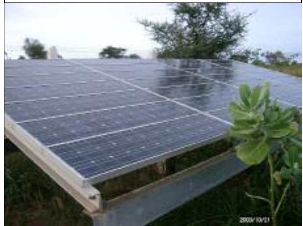
日本施工の給水施設、ソーラーパネル
