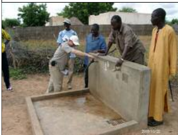
日本施工の給水施設、共同水栓
