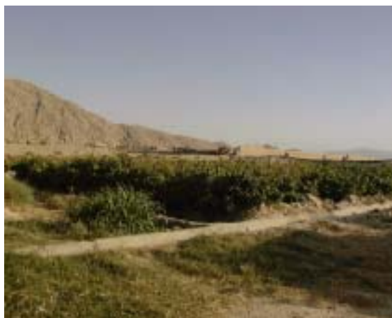
Simali 村圃場の管井(Tube well)から貯水槽 (Head storage tank)への配管(圃場側から) ③⑩
