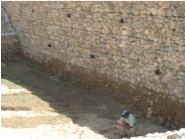
上流面にみられる洪水の痕跡
