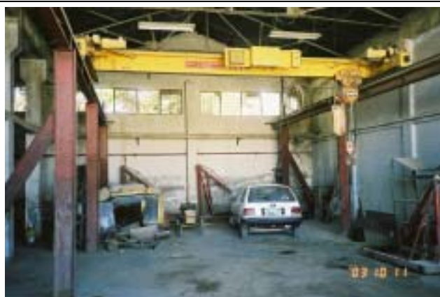
灌漑電力局修理工場に設置されている門型オーバーヘッドクレーン（吊上げ能力：8 ton） ③⑥
