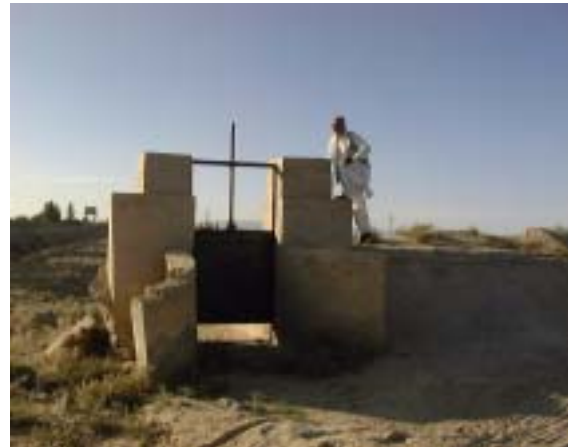
Sariab Farm Mastung Highland Sailaba の損傷した左岸取水口 ㊟
