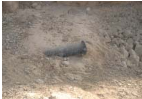
下流放流管 適切な清掃が必要である Murghai Kotal DAD ③
