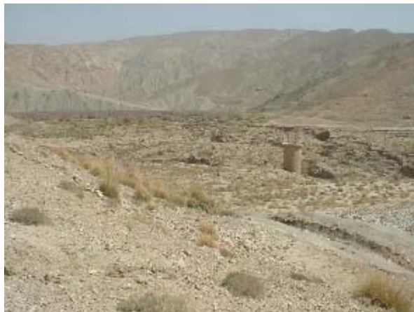
決壊の原因は、満砂による洪水吐けが機能しなかったためと説明されている ⑫
