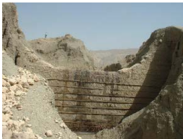
同左 破壊したコンクリート遮水壁が見える
