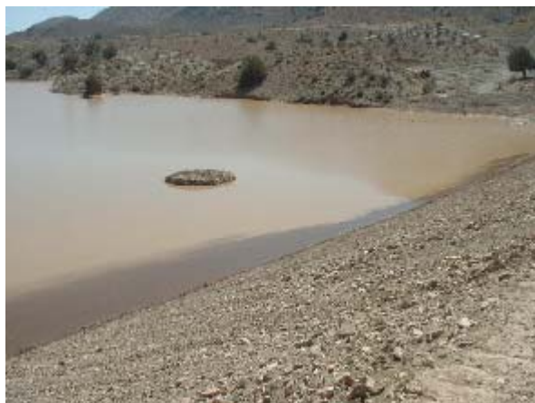
Spera Ragha DAD の取水設備
