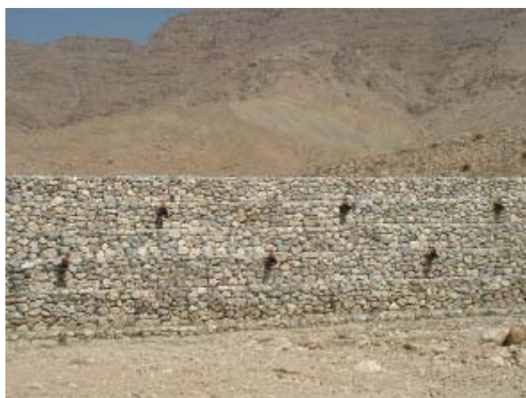
Leaky Dam 下流面。放流用パイプが据え付けられている ⑦
