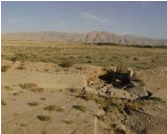
Sariab Farm Mastung Highland Sailaba の損傷した右岸取水口 ㊟
