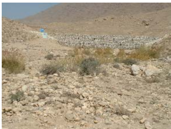
Leaky Dam 遠景
