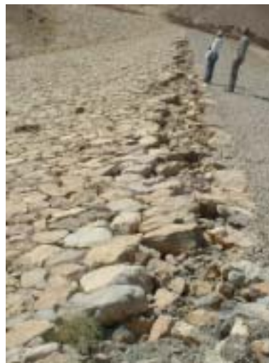
上流リップラップ石が悪戯で崩されている
