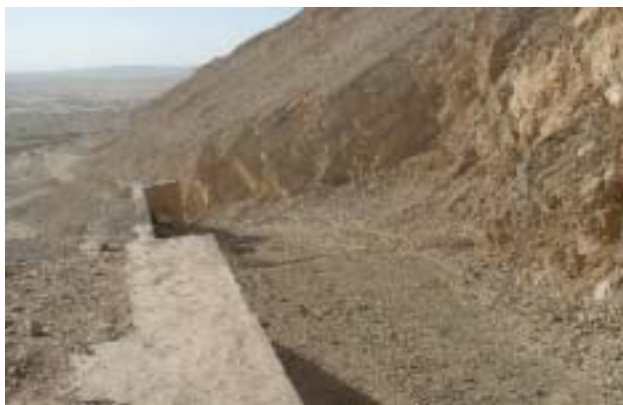
Murghai Kotal DAD の洪水吐 シュート部は地盤が剥き出しになっている ③
