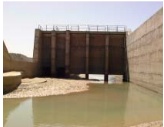
Toiwar FIS 取水堰土砂吐・取水口へのインレ ット部、土砂吐が十分機能していない ㉔
