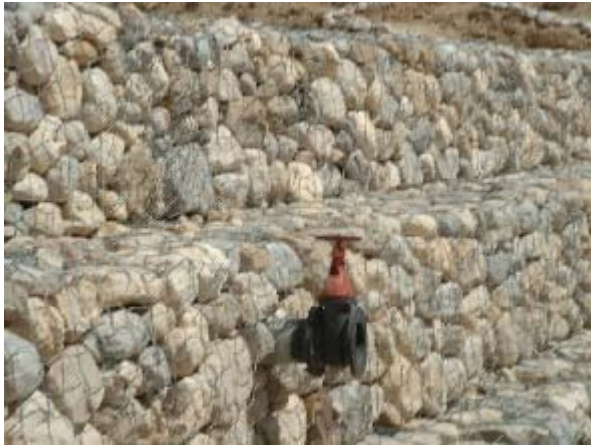
放流パイプにはバルブが取り付けられている
