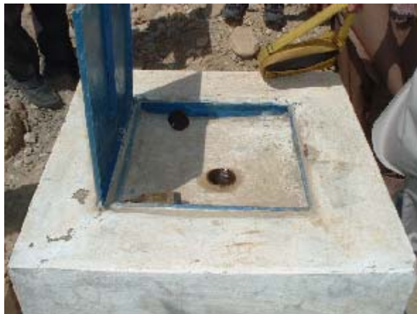
水位観測孔(Leaky Dam)
