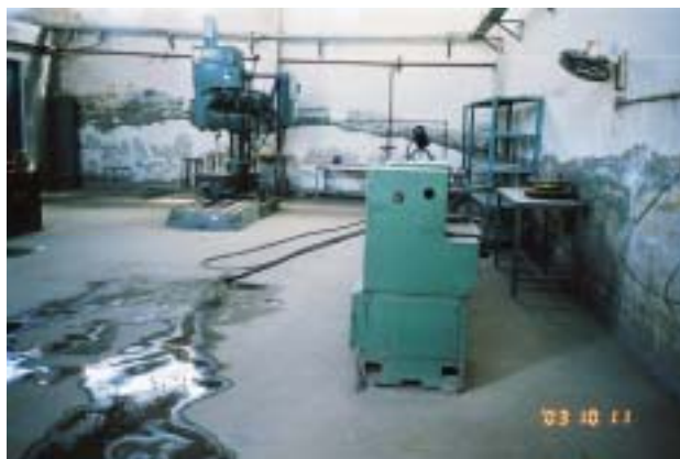
灌漑電力局修理工場に設置されている旋盤およびフライス盤 ③⑥
