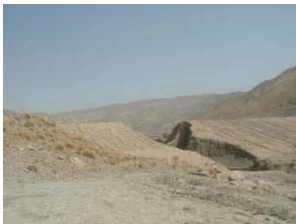
決壊した貯水ダム (Kach Dam)
