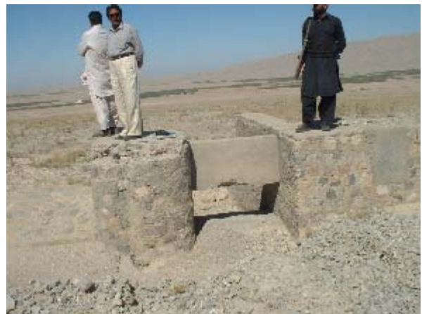
同左 土砂吐用ゲート
