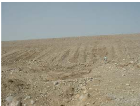
下流のり面の雨裂 (Gatero DAD)
