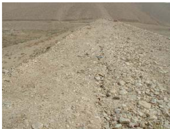
ダム軸に沿った亀裂 施工不良 Pade Naran DAD ⑩
