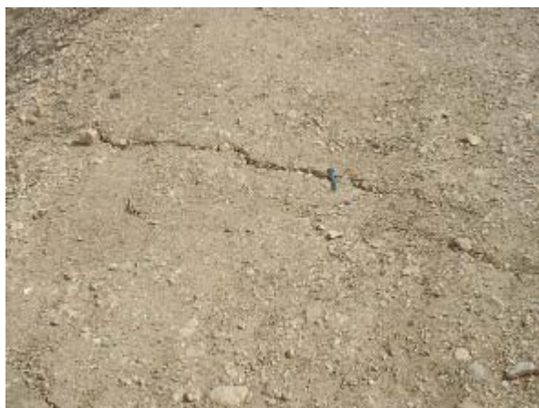
ダム天端に亀裂がみられる Pade Naran DAD ⑩
