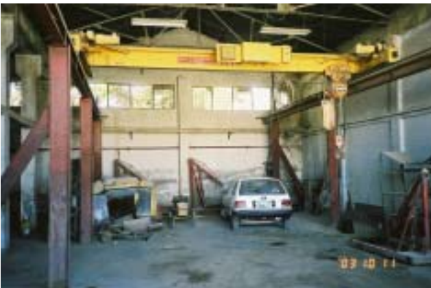
灌漑・電力局修理工場に設置されている門型オーバ ーヘッドクレーン（吊上げ能力：8 ton）
