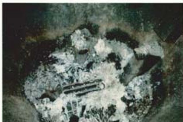
燃焼後の焼却炉内部。ほとんどのものが完全燃焼し、下の灰受け皿に落ちている。
