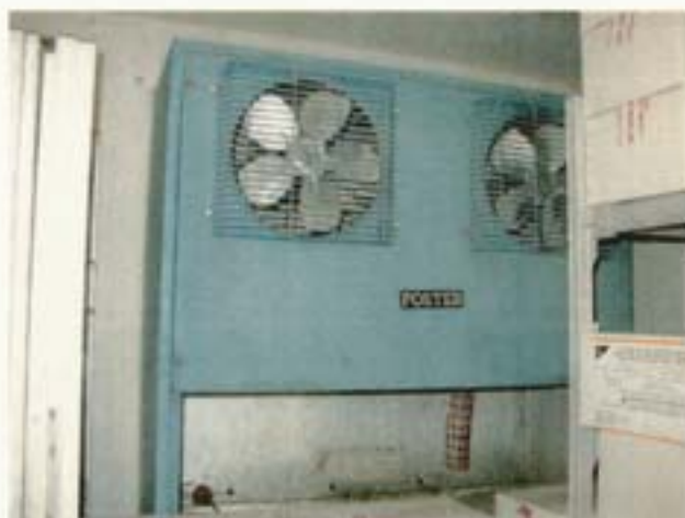
前述の冷蔵庫内部。もう一方のファンも停止しており、温度管理が難しくなっている。
