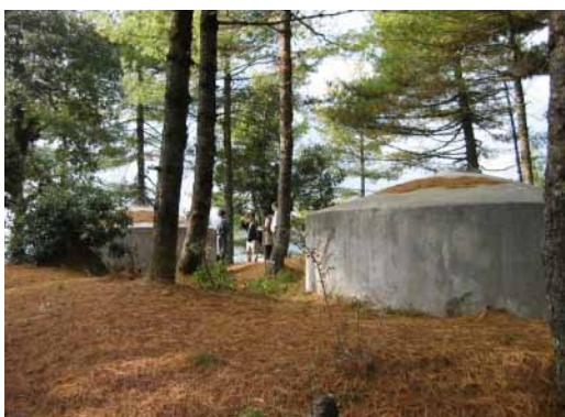
全体施設用の受水槽（コンクリート製）
