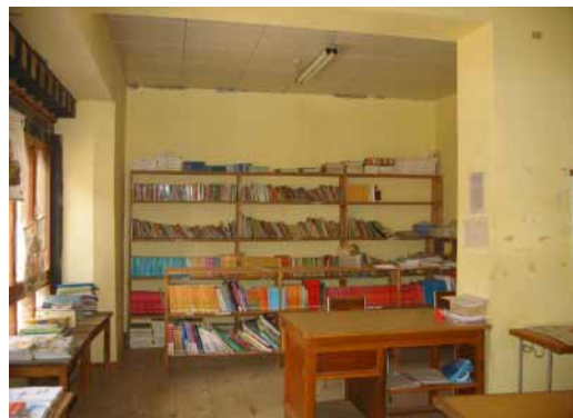
図書室内部（内部の施工がよくない）
