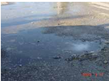
7.配水管の漏水
