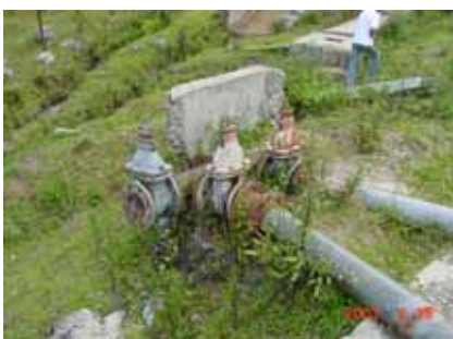
7. ヌグポ浄水場 緩速ろ過池流入管
