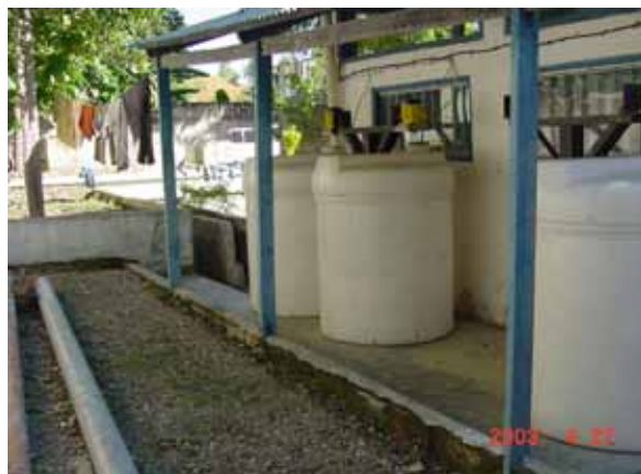
4.薬品注入設備 (溶解槽・攪拌機)
