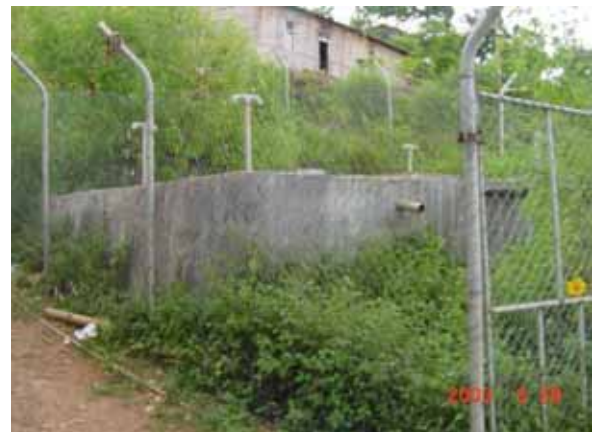
4.ポエテテ配水池
