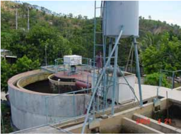
3.高速凝集沈澱池及び急速ろ過池
