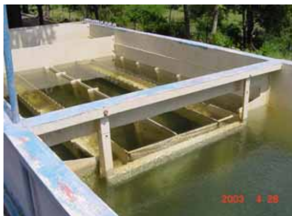
4.沈澱池・急速ろ過池
