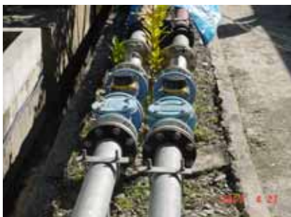
7.導水管メーター
