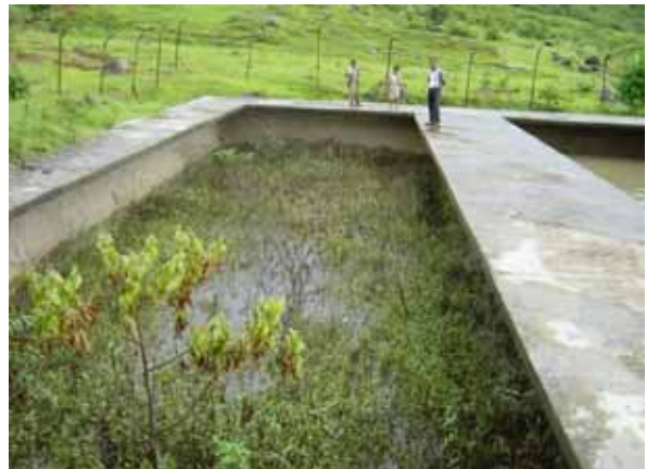
4. ヌグポ浄水場 緩速ろ過池
