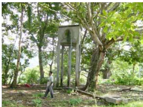
6.ポスト高架水槽
