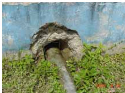
8. ヌグポ浄水場 配水池
