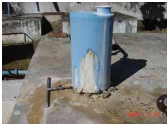
6.配水池及び滅菌装置
