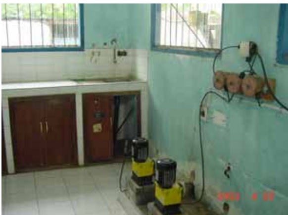
5.薬品注入室及び水質試験室
