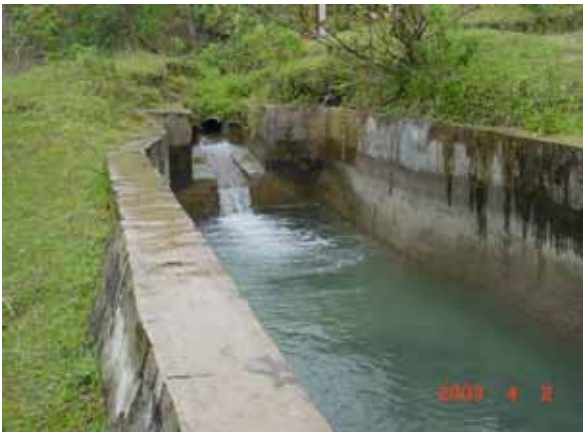
3. ヌグポ浄水場 着水井
