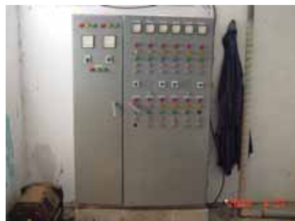
9.発電機室の盤
