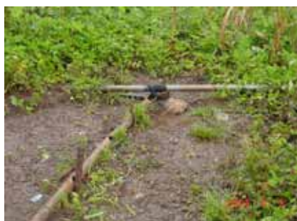
8. 不適切接続による分水
