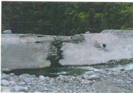
破壊されたままの砂防ダム施設
