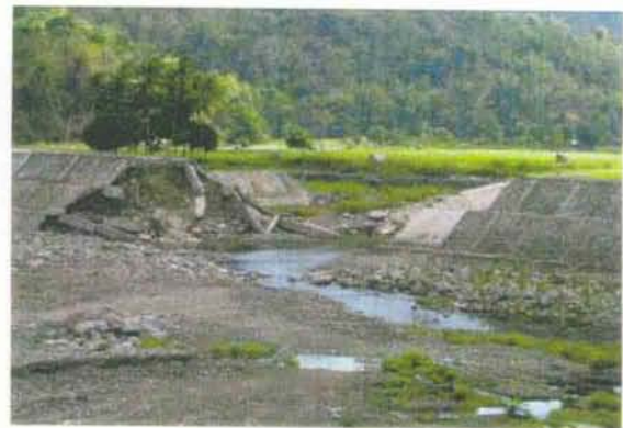
破壊されたままのサンドポケット施設
