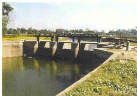
灌漑水路分水施設
