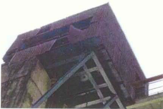
スングルーダムホイスト部、壁の剥がれと錆び
