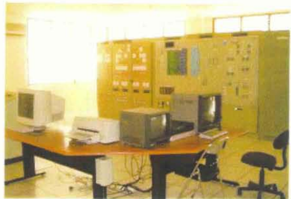
浄水場コントロールルーム
