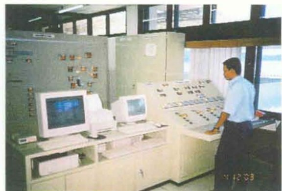
⑥ビリビリダム・オペレーションルーム
