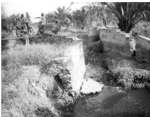
1998年完成。施工不良による施設の破損状況。長期間放置状態となっており農民の日常生活に支障をきたしている。
