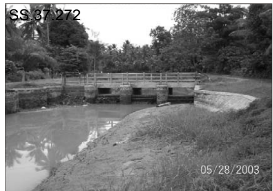
1980年完成。分土工前の土砂滞積が著しい。
