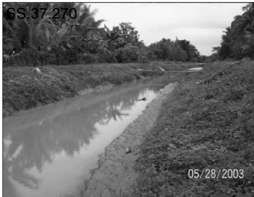
1980年完成。土水路の状況。水路法面の崩壊が著しい。
