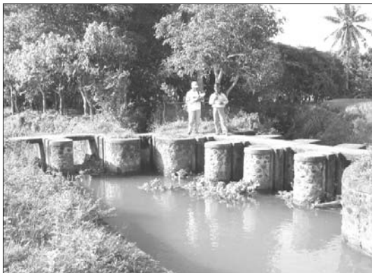
1998年完成。幹線水路上の分土工の状況。ゲートが設置されていない。土砂滞積も著しい。
