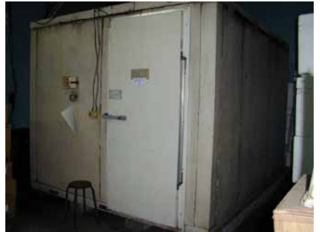
パスツール研究所のワクチン保管用冷ドルーム。全部で4室ある。
