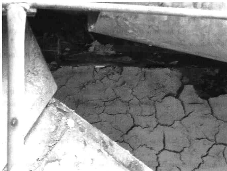
Фото 5.1-14 Трещины в верхней части котла блока № 6. Трещины в навесе котла (Видны раскаленные места в печи)
