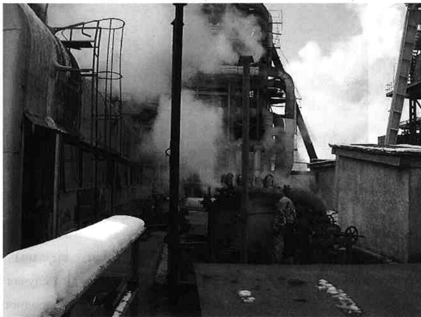
Фото. 5.1-3 Вакуумный эжектор конденсатора
