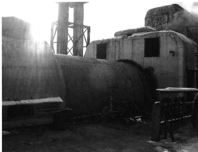
Фото. 5.1-6 Внешний вид Генератора
