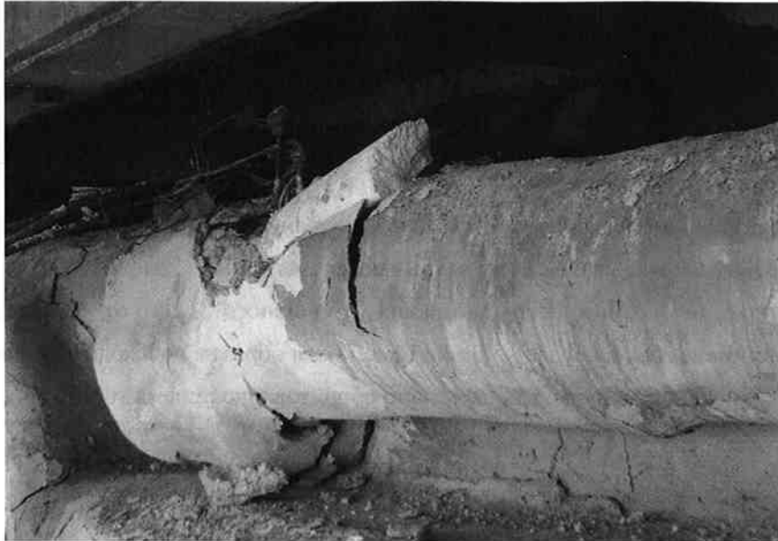
Фото. 5.1-9 Отсутствие изоляции на трубопроводах
