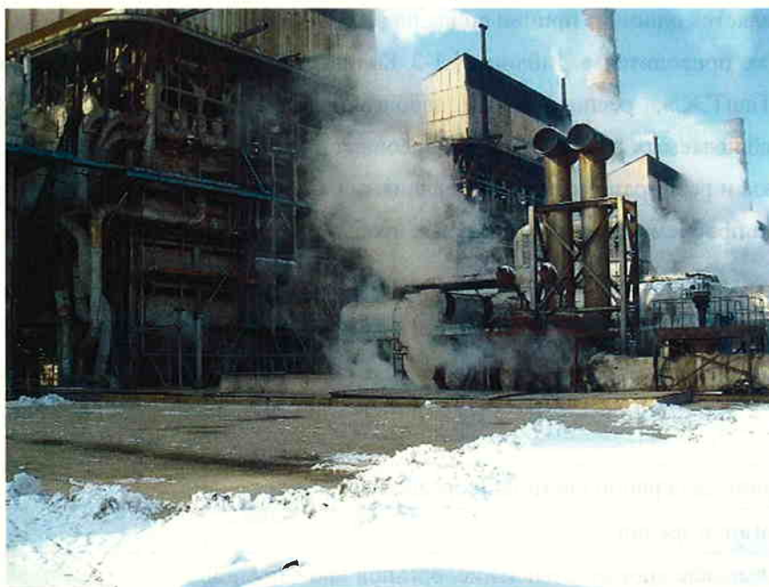
Фото. 5.1-2 Вид котла со стороны Турбины
