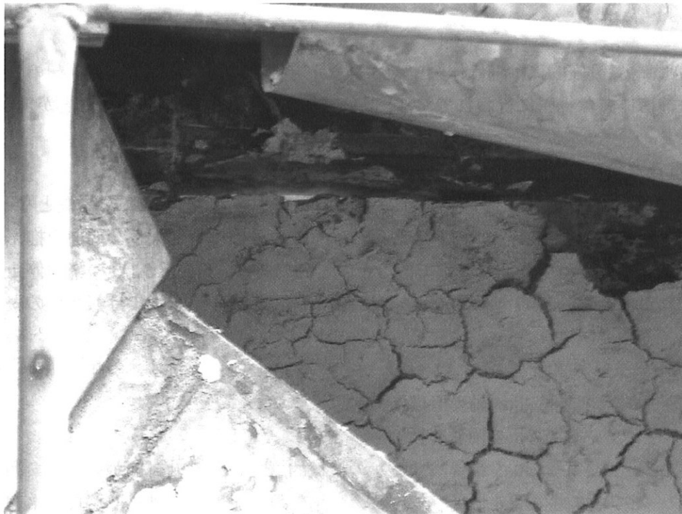
Picture 5.1-14 6号ボイラー天井部の割れ
