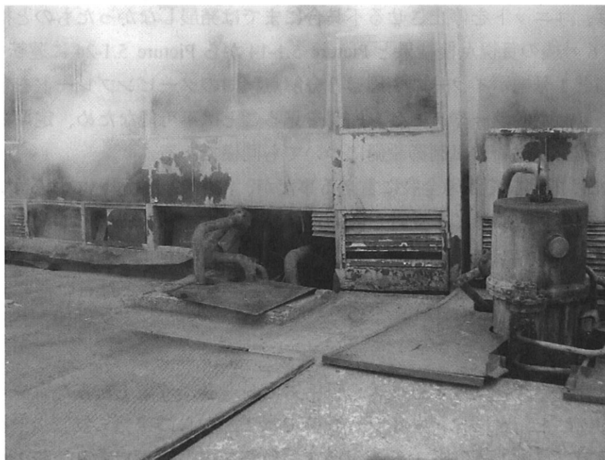
Picture 5.1-13 タービン周辺からの蒸気漏洩状況
