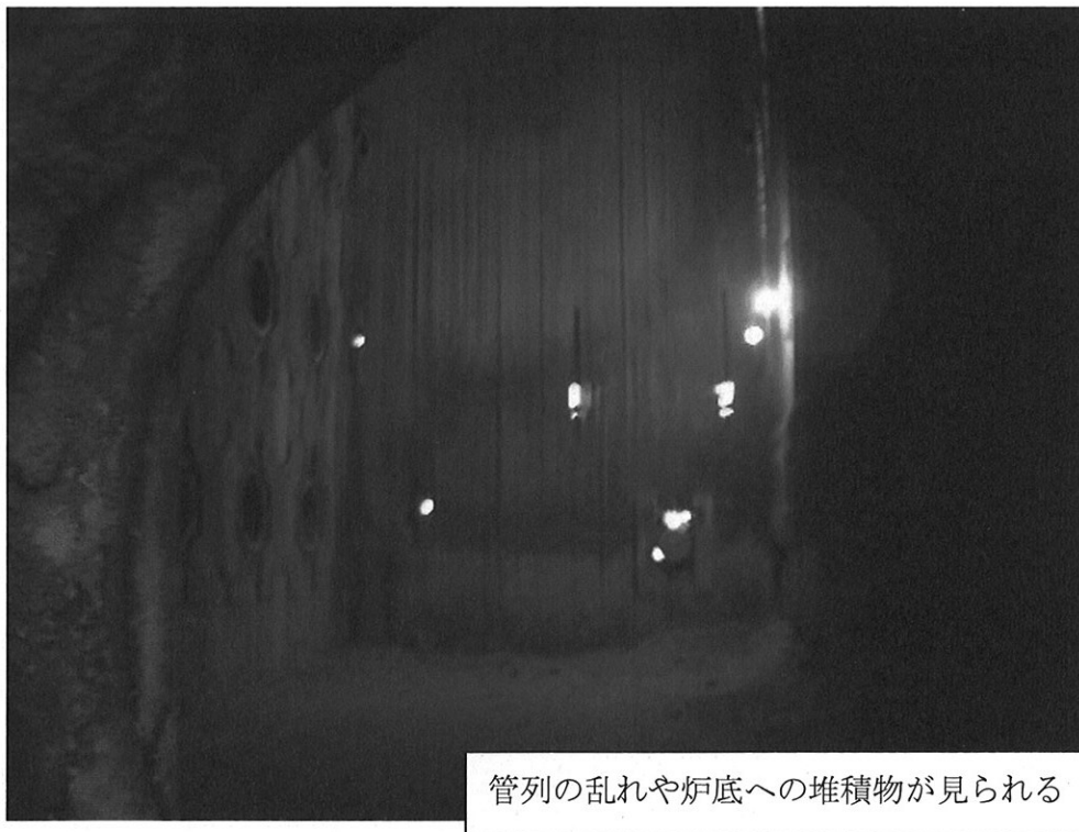
Picture 5.1-16 1号機ボイラー内部
