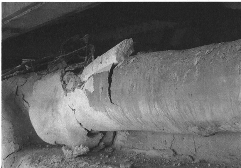
Picture 5.1-9 配管保温の脱落状況
