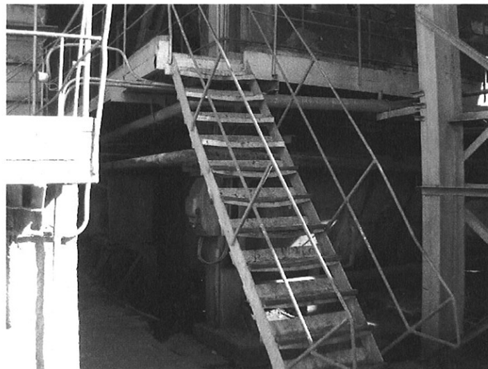
Picture 5.1-12 階段、歩廊手摺り
