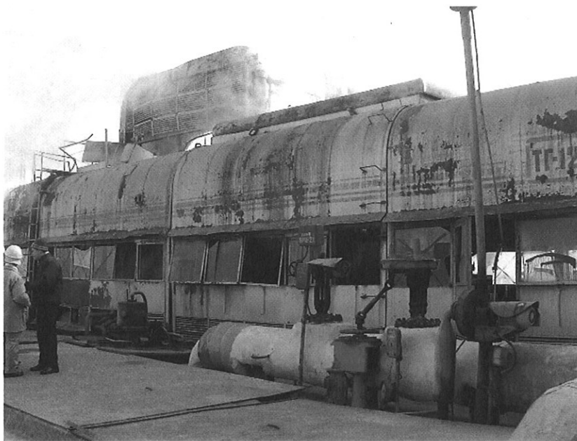
Picture 5.1-4 タービンのカバー全景
