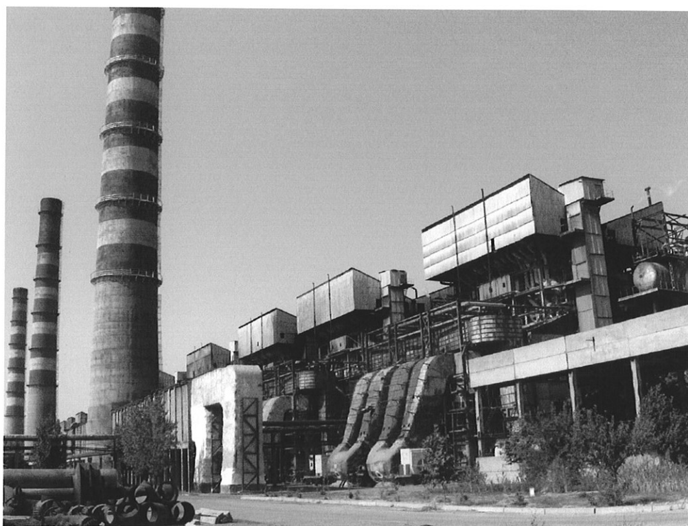
既設ボイラ設備（右から 12 号機、11 号機）
