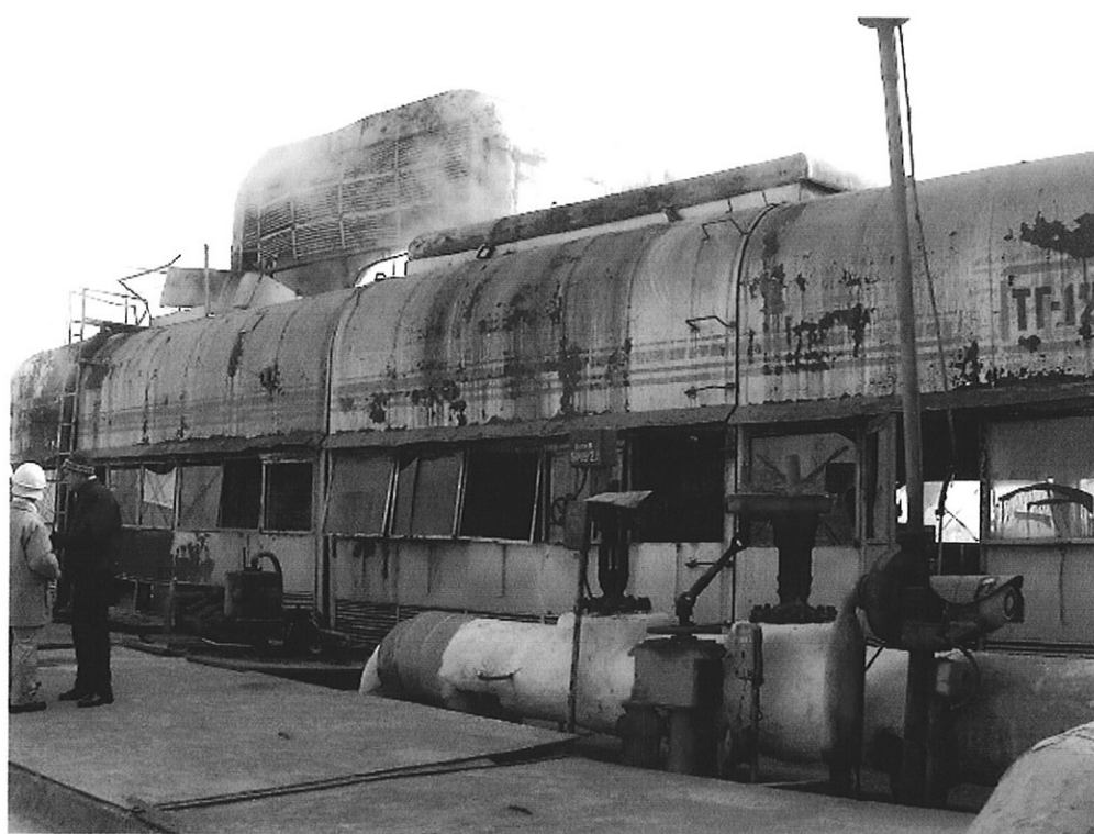
既設蒸気タービン設備
