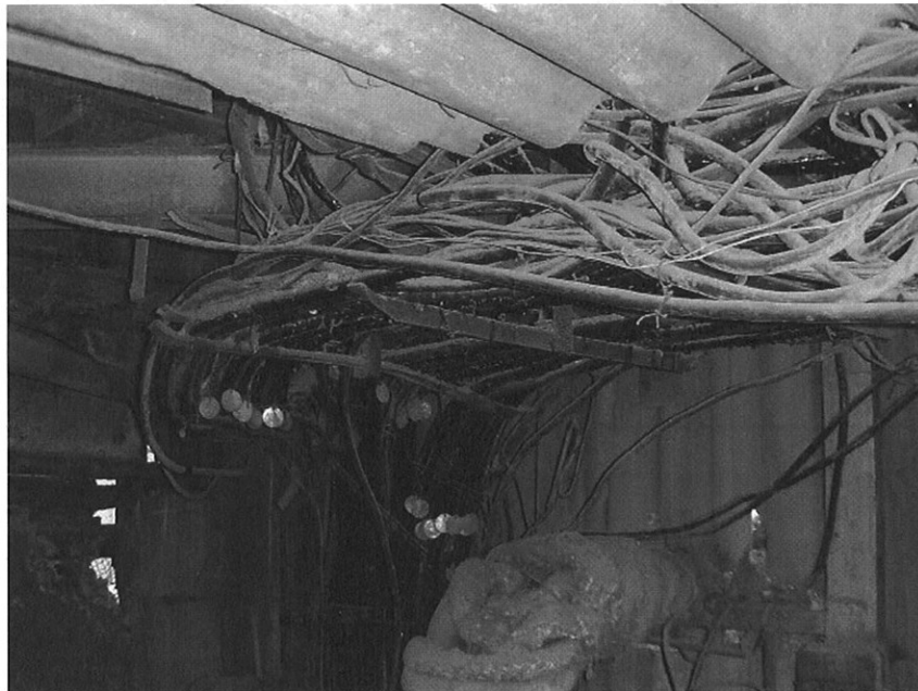
Picture 5.1-10 6号機バーナー周辺の各種ケーブル
