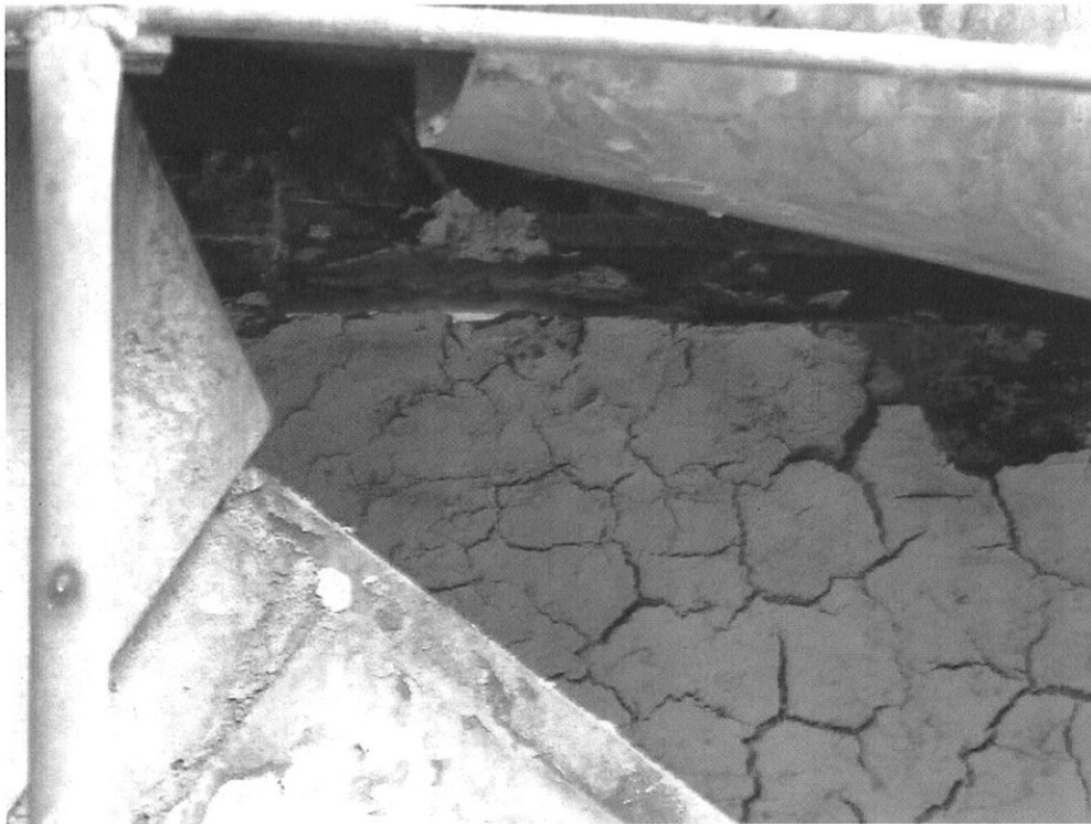
Picture 5.1-6 6号ボイラー天井部の割れ
