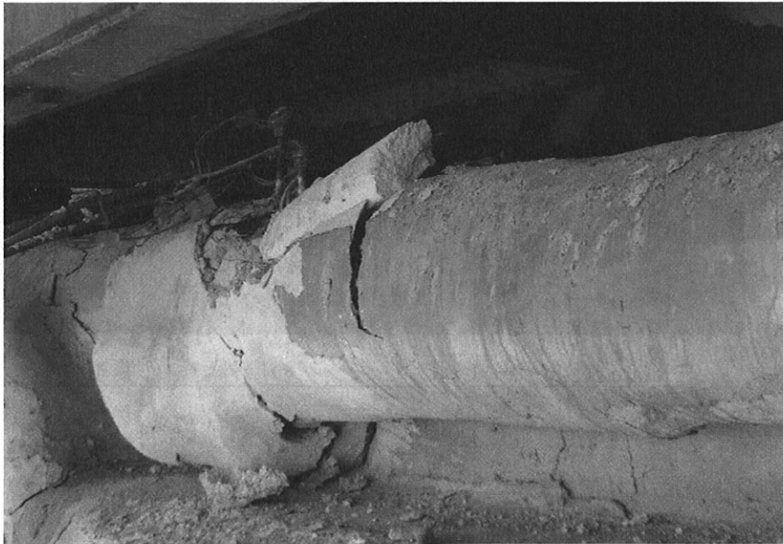
Picture 5.1-4 配管保温の脱落状況
