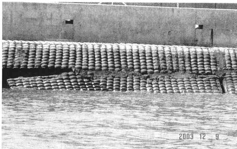
写真 6 法面の亀裂と修復状況、左の崩落塊は右にずれている。
