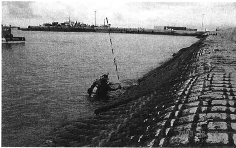
写真 2 写真1の左側のえぐられた状況確認測量
