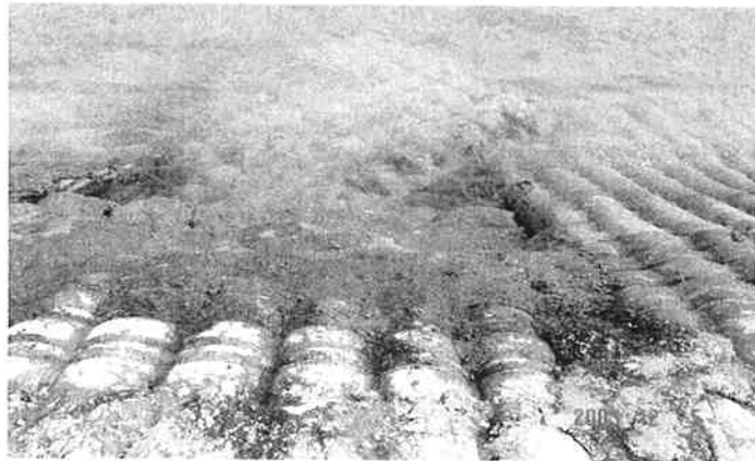
写真 8 写真7の崩落塊が法尻まで落下崩落した状況
