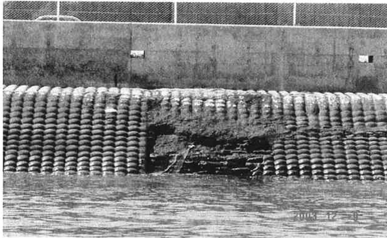
写真 7 写真6に続く破壊部補修部分と法中央部の一部崩落状況
