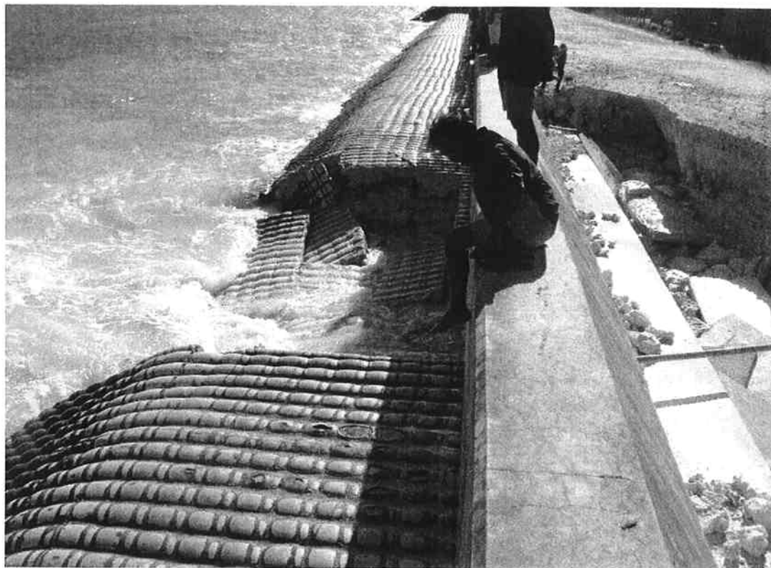
写真 4.1.2 崩落した護岸（測点 No.3～No.4）
