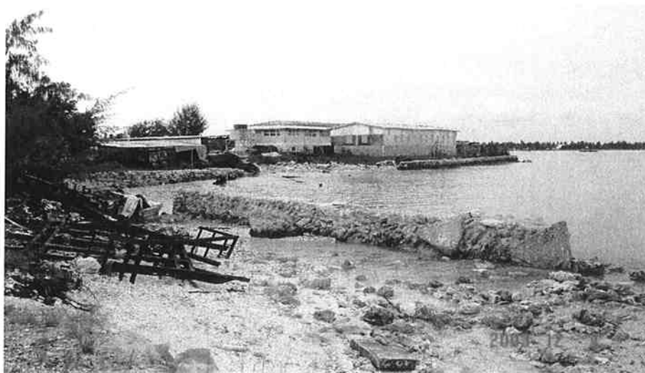
写真 4.2.1 西モール西側護岸の崩壊と流出した埋立土砂
