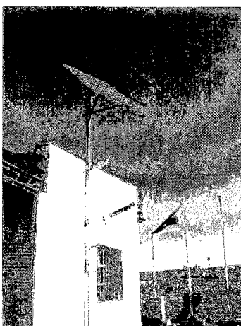
写真 6 電話アンテナ(太陽電池パネル下)
