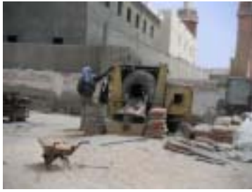
Central à béton NDB
