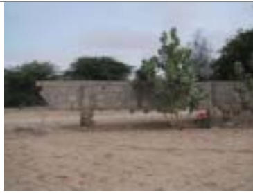
Clôture endommagée NKC
