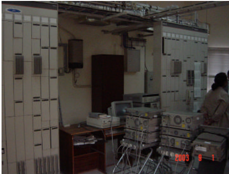
NTI 多重無線システムラボ (無償資金協力で調達した機材)
