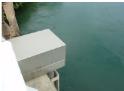
水位計ケーブルジョイント部
