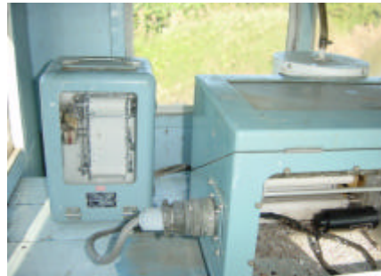
雨量計は稼動している。
