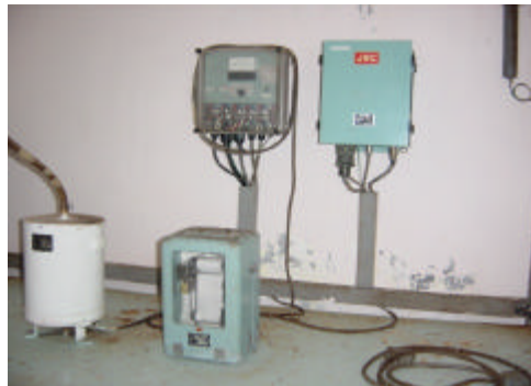
雨量計、雨量記録器、テレメータ送受信機等
