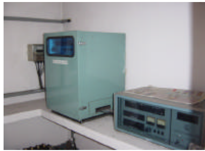
AD変換機、デジタルレコーダー
