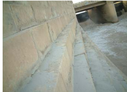
写真 4.13 右岸アバット陥没の砂流出
