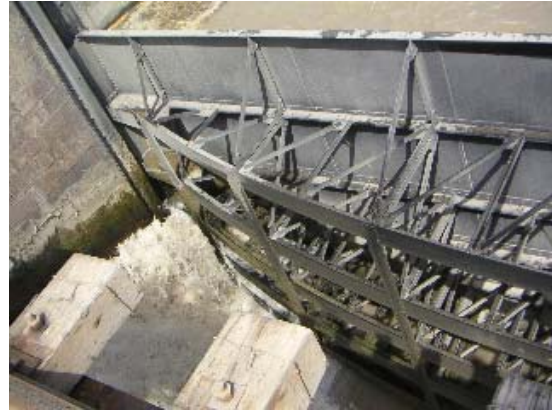
写真 4.19 洪水吐ゲートからの漏水状況
