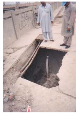
写真 4.9 左岸アバット背後陥没
