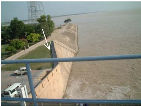
写真 4.8 左岸アバット背後陥没箇所
