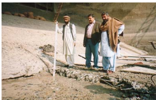
写真 4.2 スキンコンクリートの剥離
