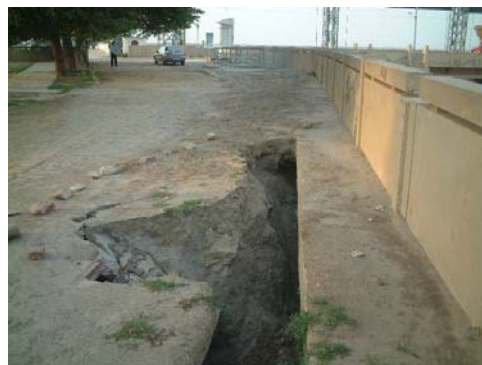
写真 4.11 右岸アバット背後陥没
