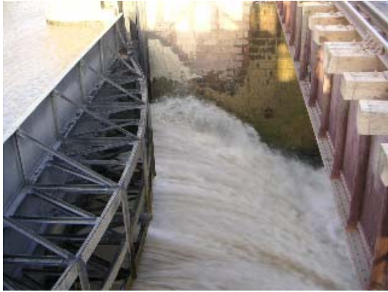
写真 4.18 土砂吐ゲートからの漏水状況
