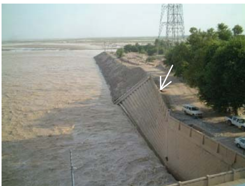
写真 4.10 右岸アバット背後陥没箇所
