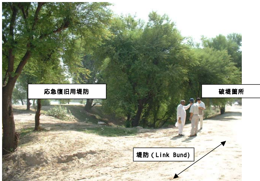
写真-7 タウンサ堰上流右岸堤防の1996年洪水による破堤箇所
