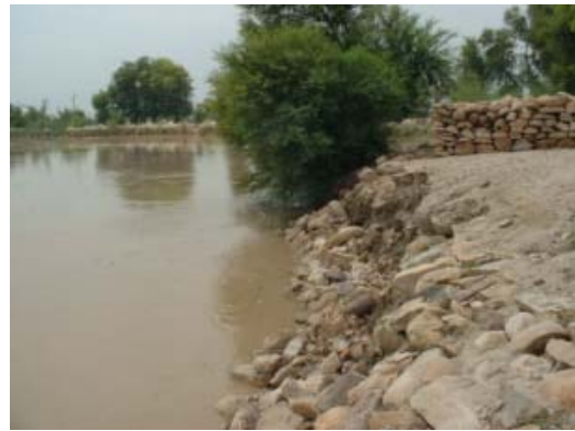
写真-6 水制工先端部の侵食状況 (J-Head Spur No.5)
