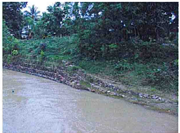
Alo-Pohu 川右岸の崩落した蛇籠護岸
