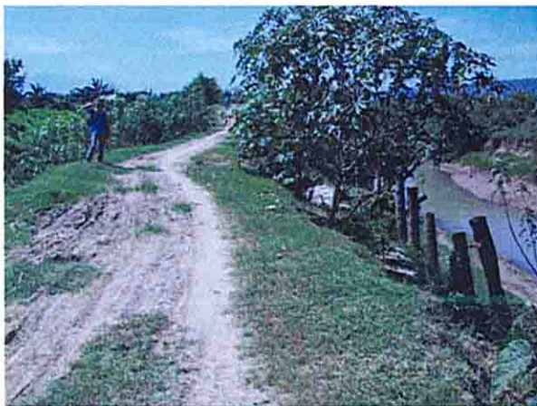
Alo-Pohu 川左岸の破堤箇所
