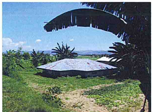
Alo-Pohu 川沿いの民家 (堆砂に埋まっている)
