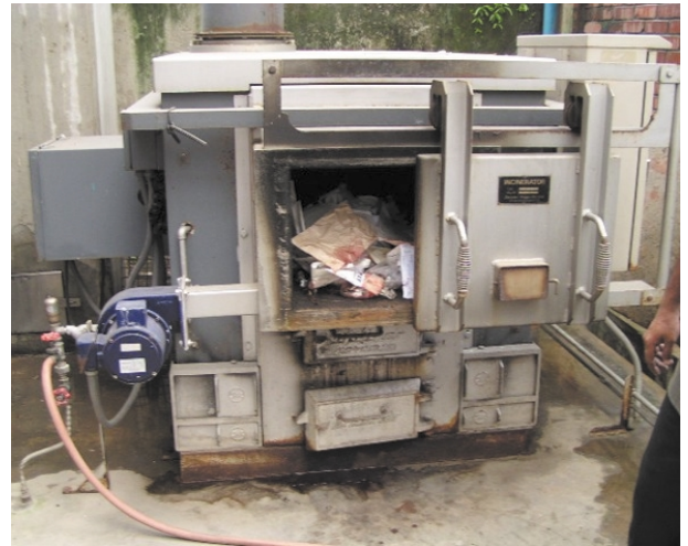
母子保健研修所に設置された感染ゴミ焼却炉
