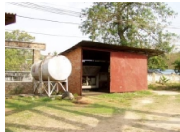
Photo 12 : Generator ( 130kVA + 100kVA )
