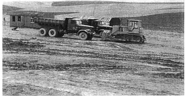
A378号線 カシュカダリヤ州管轄区間 拡幅工事現場で稼動中建設機械
