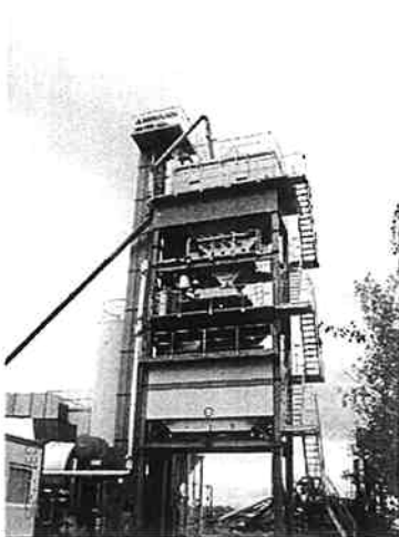
ウズベキスタン道路公社 サマルカンド州支部アフロシヨブ道路開発局 アスファルトプラント(ドイツ製)2003年8月設置
