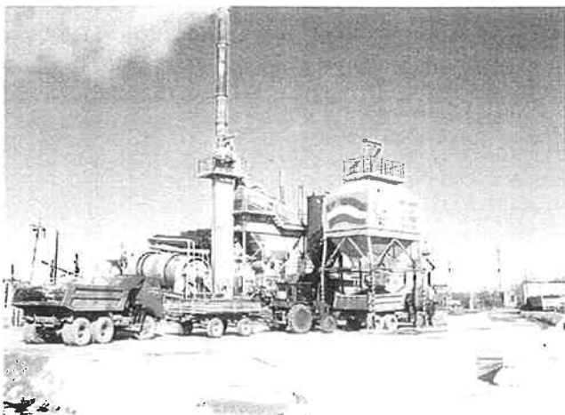
カシュカダリヤ州道路公社 アスファルトプラント工場
