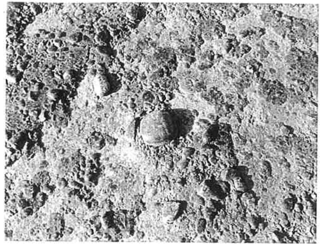
4P87号線 路面状況
