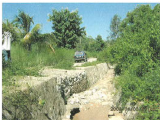
42) 側溝損壊状況 (STA126+700)
