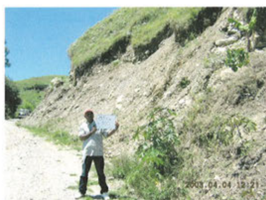
21) 切土法面浸食状況 (STA81+100)
