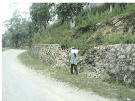
8) 練石積擁壁崩壊状況 (STA22+580)
