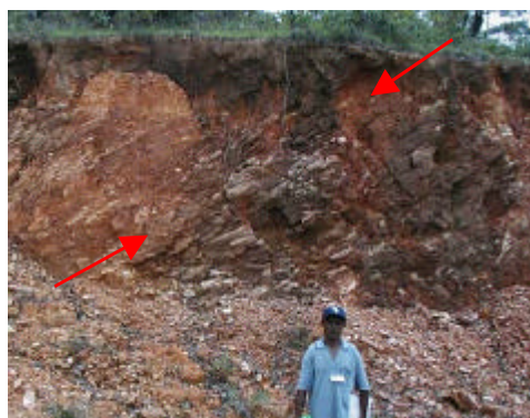
道路法面にみられる風化した片岩（km24.6） 矢印の方向に片理（分離面）が発達
