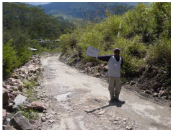
写真 - 3.2 km109+800 付近：山側地すべり
