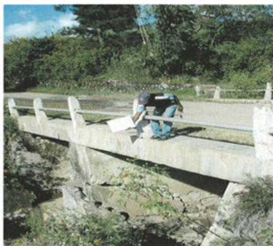
17) 橋脚破壊状況 (STA60+300)
