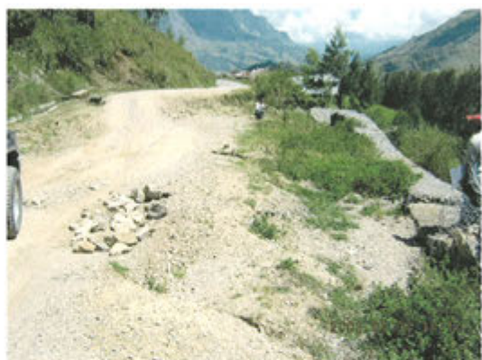
22) 道路陥没状況 (STA83+500)
