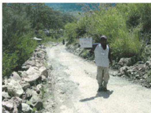
36) 道路損傷状況 (STA109+800)
