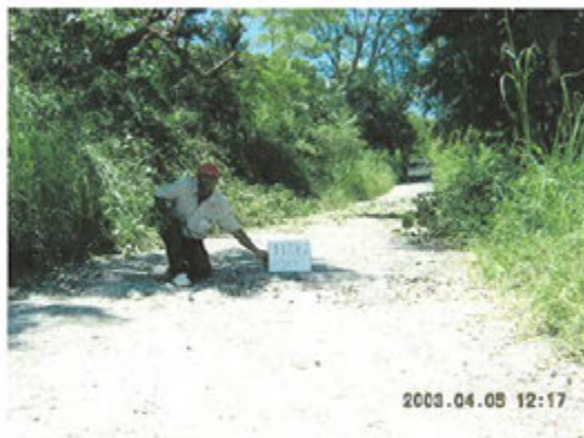
39) 道路損傷状況 (STA117+000)
