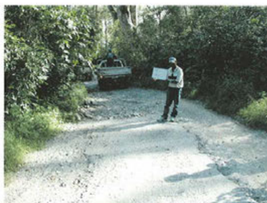
30) 路肩陥没状況 (STA91+700)
