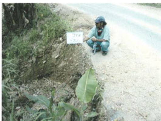
3) 路肩部崩壊状況 (STA9+700)
