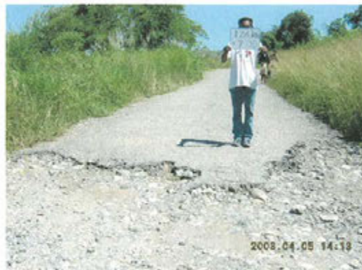
41) 道路損傷状況 (STA124+700)
