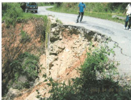
11) 路肩部崩壊状況 (STA40+500)
