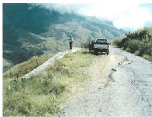
28) 路肩陥没状況 (STA91+200)
