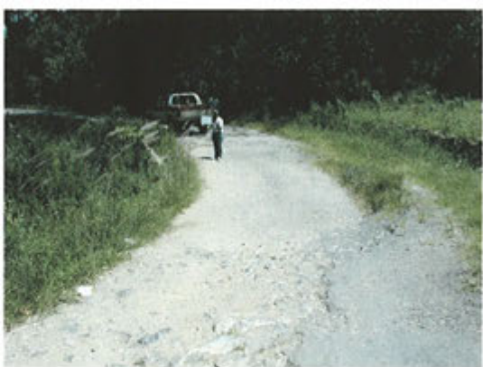
27) 道路陥没状況 (STA89+300)
