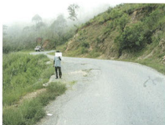
7) 路肩部損傷状況 (STA20+950)
