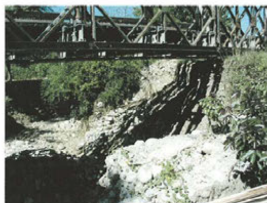
45) 練石積護岸工崩壊状況 (STA140+900)
