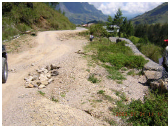
写真 - 3.1 km83+500 付近：谷側地すべり
