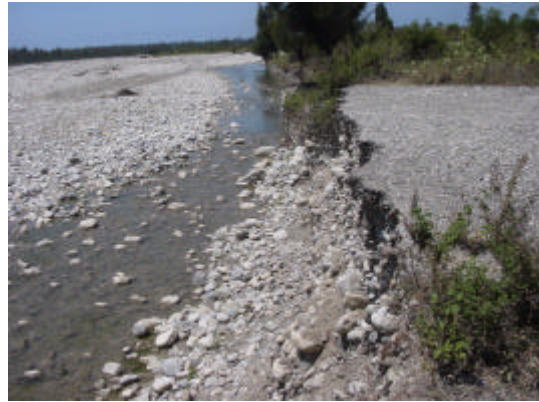
写真 - 2.6 モラ橋右岸側（浸食状況）
