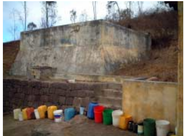
給水順番待ちのバケツ (計画対象サイト No.30 Rui Vaz)
