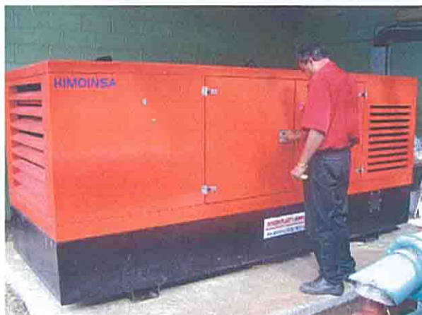
メディアセンター、ITS他用発電機 (150KVA)
