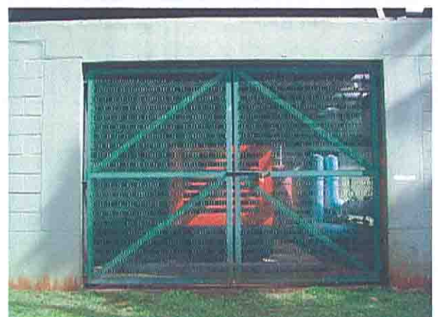
メディアセンター、ITS他用発電機格納庫
