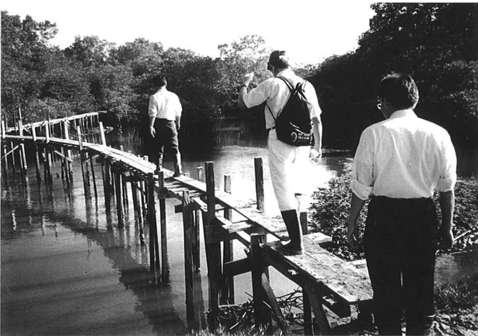
マングローブパークの木道の様子（部分的に改修が必要となっている）
