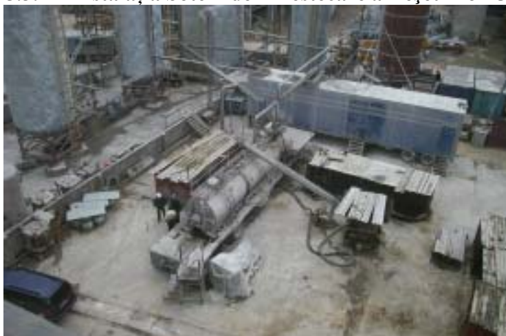
Figura 5.3.1 – Instalația Sotem de Amestecare a Deșeurilor Organice
