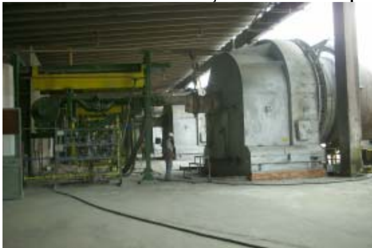
Figure 5.3.2 – Sistemul de Alimentare cu Deșeu Amestecat la Cuptorul de Ciment
