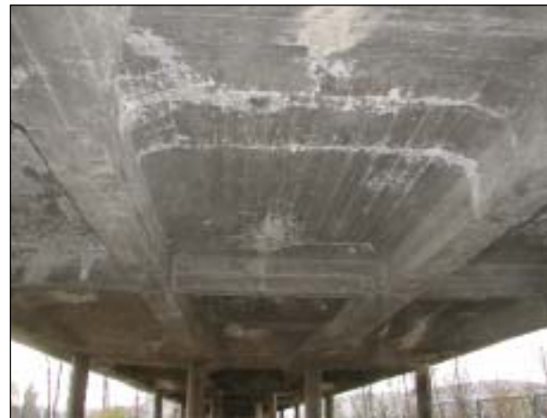
D-05 側径間部 床版損傷状況
