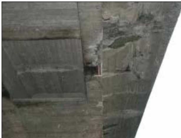
D-04 主径間部 桁損傷状況
