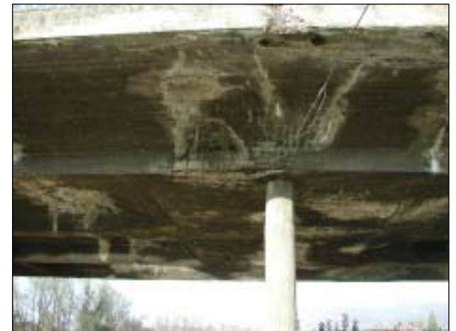
D-06 側径間部 激しく劣化した橋梁主要部材
