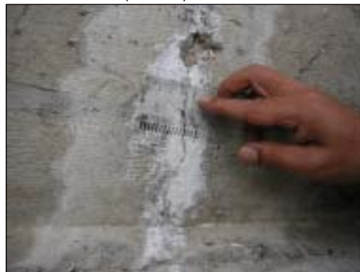
M-7 横桁に発生しているひび割れ幅0.8mm
