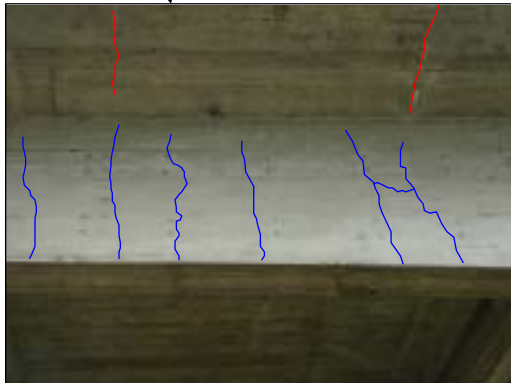
M-2 主桁支間中央部に発生しているひび割れ
