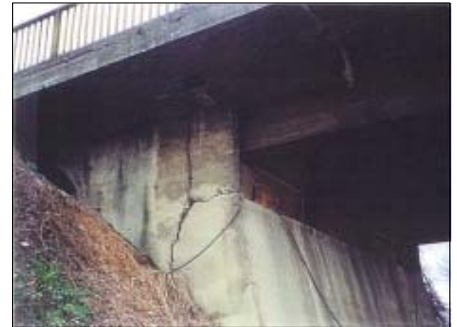
D-03 主径間 A1橋台の損傷状況
