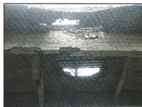
O-3 爆撃によって桁・床版に損傷を受けた径間
