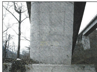
O-6 橋脚柱基部損傷状況 (P3橋脚)
