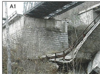
O-5 A1橋台および落橋した桁
