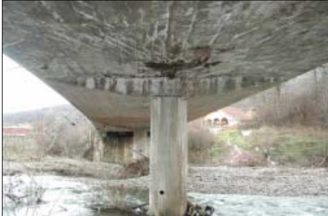
床版下面の損傷状況。
