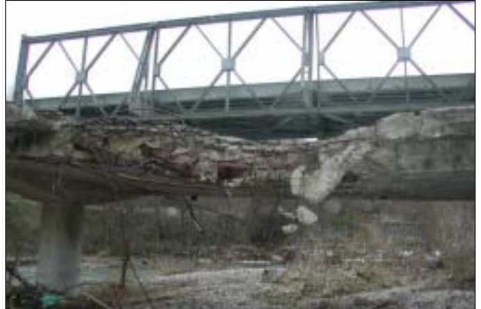
爆撃によって破壊された床版。
