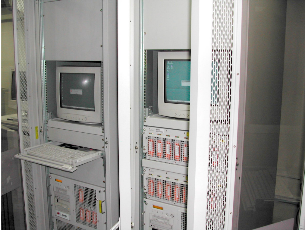
サーバールーム
