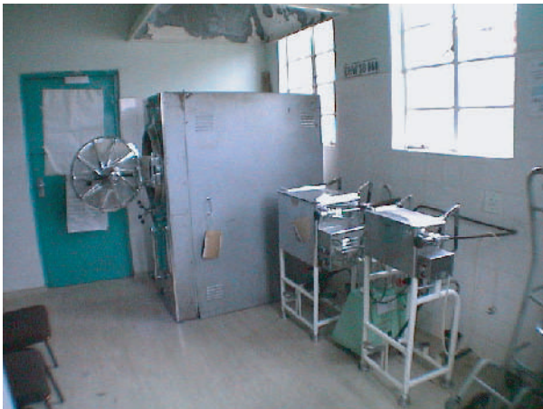
高圧蒸気滅菌装置
